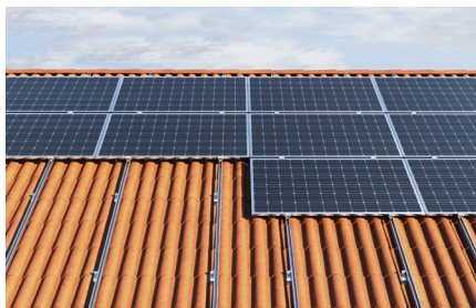
Upevnění vodorovně orientovaných FV panelů na šikmé střeše
